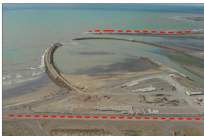
Figura 18: Afloramiento de restinga frente a Playa Magagna (afloramientos calcáreos naturales) y etapa constructiva de las obra de abrigo
