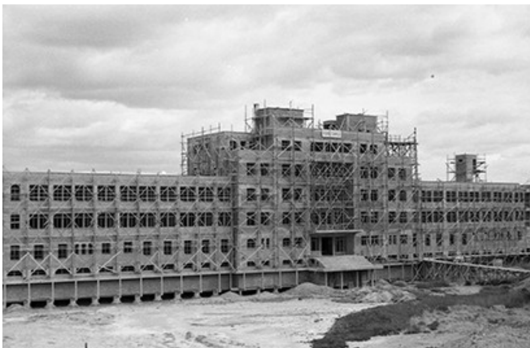
Ilustración N.º 3: Fotografía de la construcción del Hospital Regional. En la parte superior y central se ubica letrero con la leyenda “Perón cumple”, Comodoro Rivadavia, 1951 aproximadamente. Imagen tomada por el fotógrafo de la Gobernación Militar, José González
